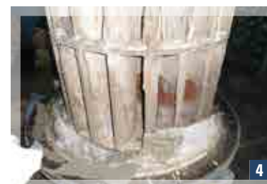
4 Incrostazioni girante testata. Deposits on the impeller and the end shield.
