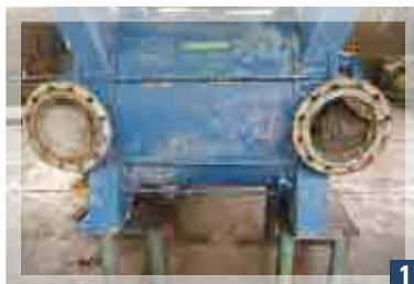
1 Pompa da revisionare tipo Siemens 2BE1. Vacuum pump to repair type Siemens 2BE1.
