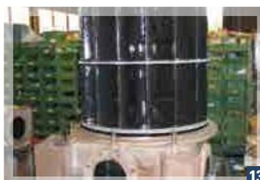
13 Rimontaggio pompa. Pump assembly.
