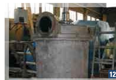
12 Rimontaggio pompa. Pump assembly.
